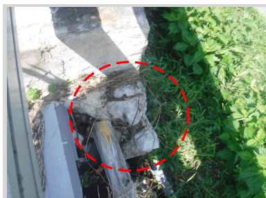
□ 현황: 연석 파손/철근노출
