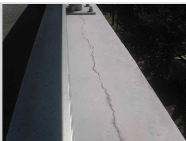
□ 현황: 연석 균열(0.3mm이상)
