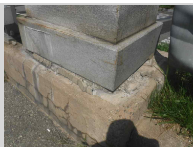
□ 현황: 교명주 기초콘크리트 파손
